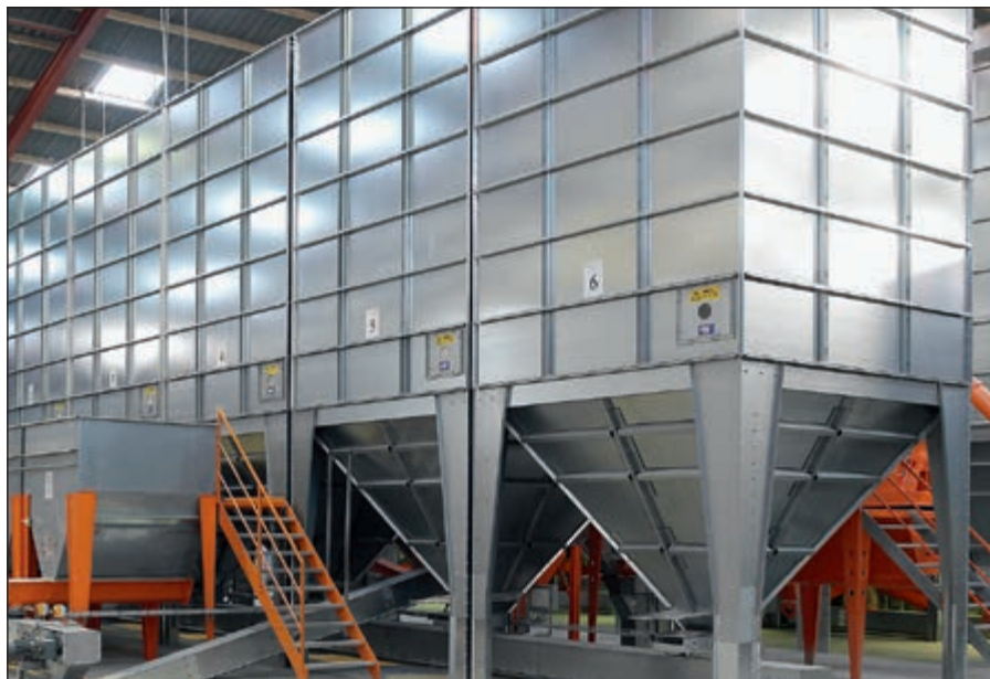
Indendørs siloer til opbevaring af den færdige blanding
